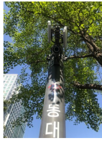
방범 CCTV 및 Wi-Fi 네트워크 폴
